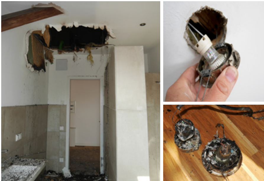
Die Feuerwehr hat die Zwischendecke im Bereich der Halogenstrahler geöffnet. Rechts sind ein Strahler mit Einbautopf aus einem anderen Raum zu sehen und (unten) ein Halogenstrahler aus dem Brandbereich, an dem verbrannte Zellulosefasern haften.
