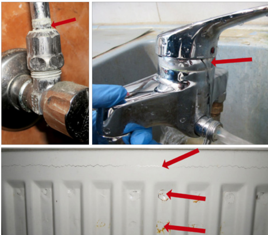
In dem Einfamilienhaus fand das IFS typische Frostschadenbilder: eine auseinandergedrückte Verbindung, eine gebrochene Armatur und ein aufgefrorener Heizkörper.
