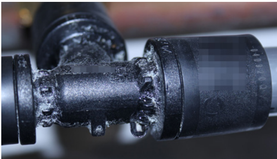
Die weißen Ablagerungen auf dem T-Stück sind Reste von Montageschaum, der in diesem Fall Risse im Werkstoff verursacht hat.
