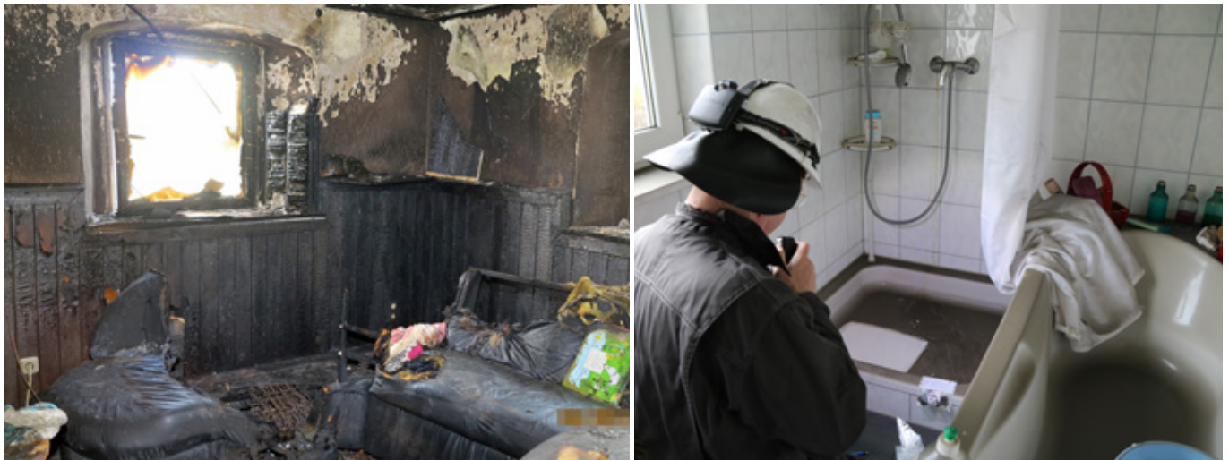
Der Brand im Wohnzimmer (links) hat ein relativ kleines Ausmaß. In dem weitläufigen Bauernhaus ist das Badezimmer im Obergeschoss am weitesten vom Brandraum entfernt. Dennoch ist dort jede Oberfläche mit Rauchgaskondensaten belegt.
