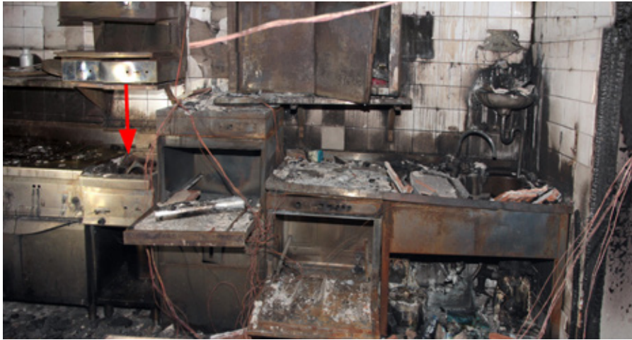
Die ausgeprägten Brandschäden in der Küche gingen von der Bain-Marie aus (Pfeil).
