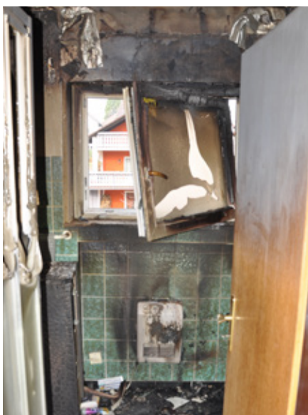
Blick auf den Heizlüfter im Badezimmer
