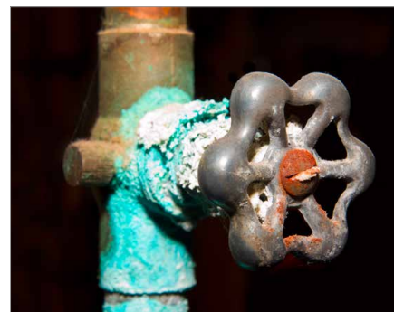
Diesem Absperrventil wurde schon länger keine Aufmerksamkeit gewidmet.
