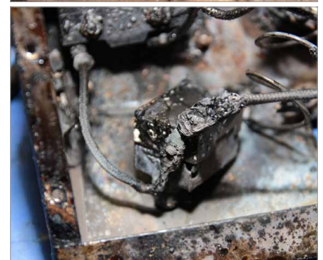
Blick auf die elektrotechnischen Komponenten: Der Schutztemperaturbegrenzer ist im rechten Fritteuse Becken korrekt angeschlossen (oberes Bild), im linken Fritteuse Becken wurde das gleiche Bauteil überbrückt.
