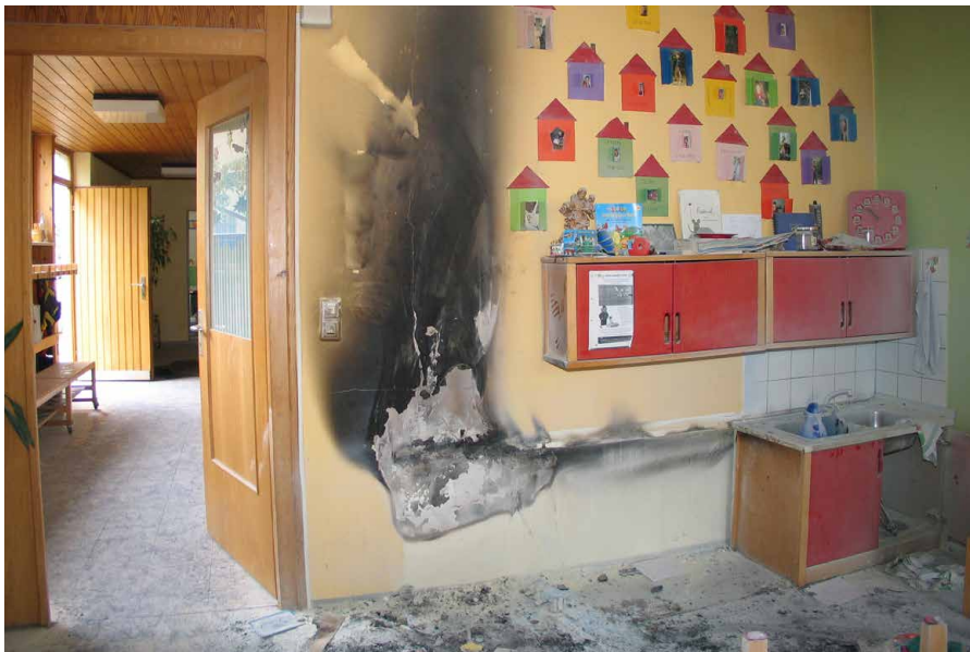
Diese Brandstelle in einer Kita gehört zum Gefahrenbereich 1.
