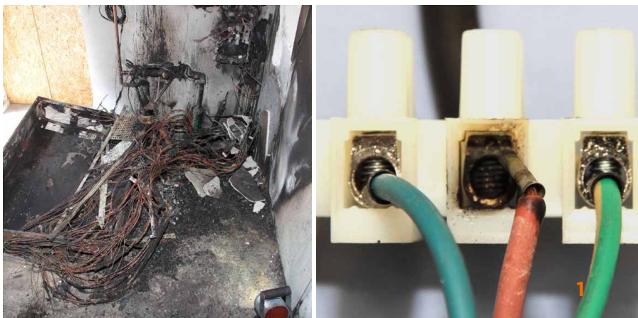
Die Reste der Elektroverteilung. Rechts ist die im Laborversuch nachgestellte Fehlerstelle zu sehen: Am mittleren Kontakt wurde das Aderende nicht in die Klemme eingeführt.
