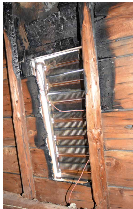
Schadenbild nach einem relativ kleinen Brand an einer Indach-Anlage.
