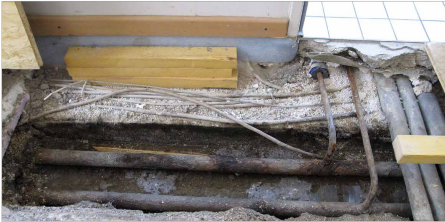
Im unzugänglichen Bodenkanal steht Wasser; die Rohrleitungen sind stark korrodiert.
