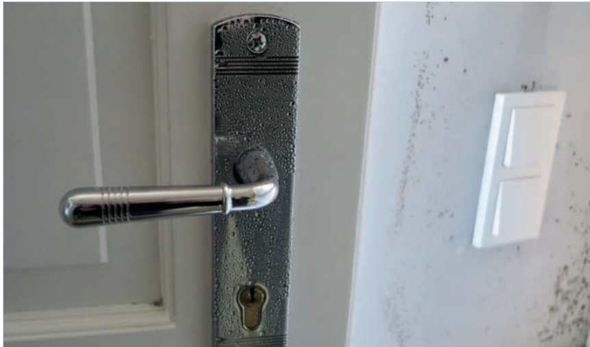
Auf dem Langschild des Türgriffs hat sich Kondenswasser gebildet. Im Hintergrund ist Schimmelbefall an der Außenwand zu erkennen.
