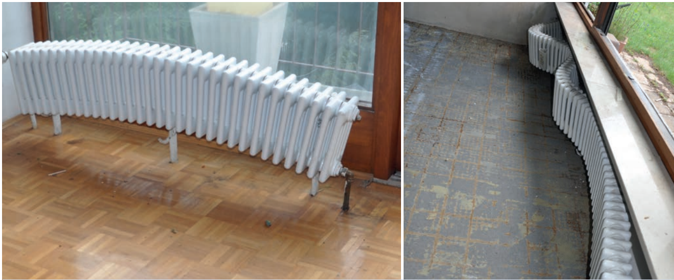
Schadenbilder aus einem leerstehenden Haus: Das Wasser in den Heizkörpern war eingefroren und hat sie so bizarr verformt.
