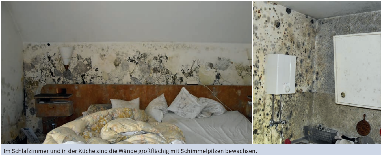
Im Schlafzimmer und in der Küche sind die Wände großflächig mit Schimmelpilzen bewachsen.
