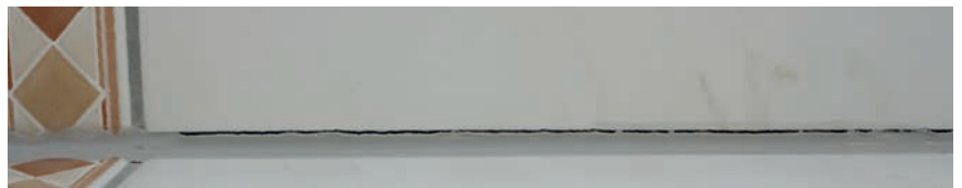
Die Silikonmasse hat sich am Rand gelöst; hier ist die Abdichtung nicht mehr gegeben.
