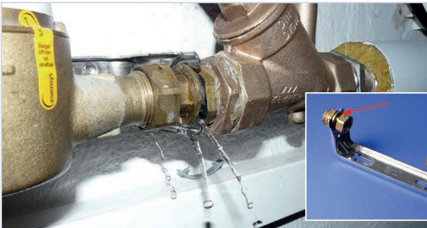
Leckage an einem Wasserzähler. Das kleine Bild zeigt eine Anschlussgarnitur von Beulco. Der Pfeil markiert die Schwachstelle am Gewindestutzen.
