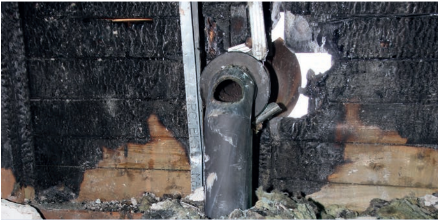
Der Abstand zwischen Abgasrohr und Holzbauteilen war hier zu gering.
