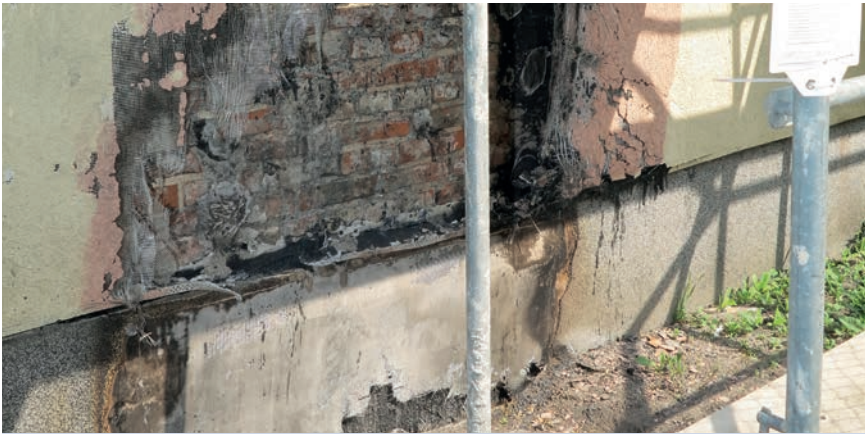
Feuer hat von einer Mülltonne auf die gedämmte Fassade übergegriffen.
