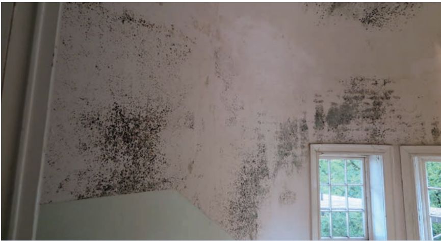
Großflächiger Schimmelbefall an den Wänden – hier wurde zu spät gehandelt.
