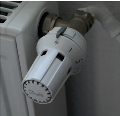
Die Frostschutz-Einstellung schützt die Heizung, nicht die Trinkwasserleitungen.
