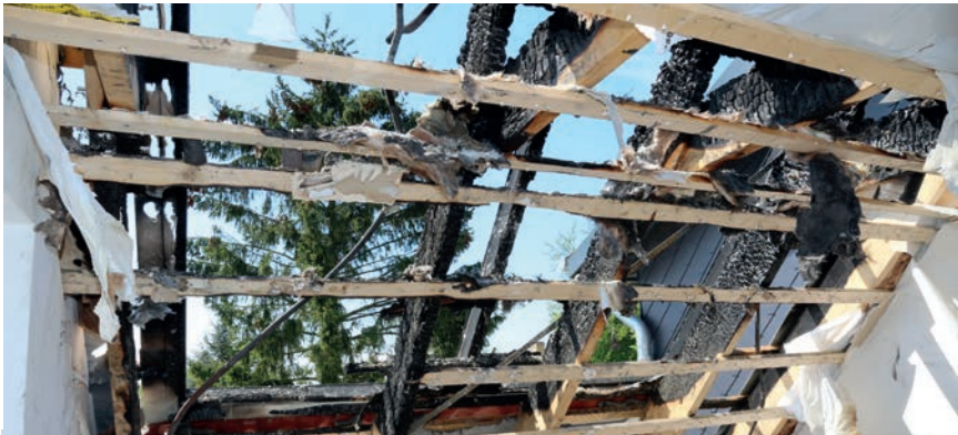
Freier Blick gen Himmel: Das Dach wurde beim Brand zerstört.
