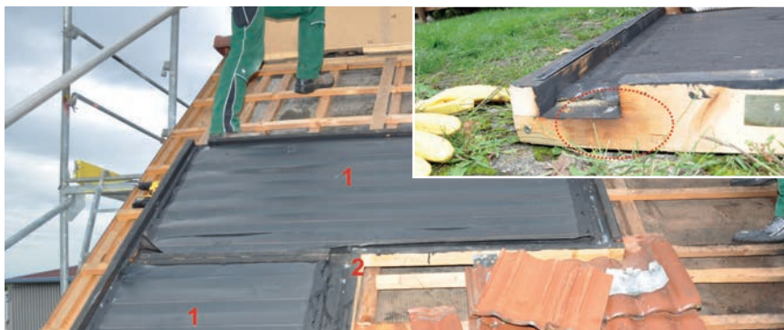
Eine Solaranlage wird demontiert: Das Solarglas wurde bereits entfernt. Darunter sind die Absorberbleche (1) und der schwarz gefärbte Holzrahmen (2) zu sehen. Kleines Bild: Im markierten Bereich wurde das Holz des Rahmens durch Hitzeeinwirkung verfärbt.
