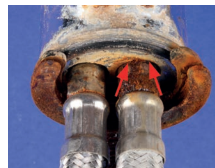
Der Warmwasseranschluss der Armatur ist stark korrodiert und undicht.
