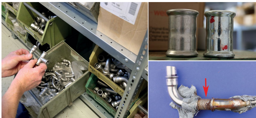
Auf die Ordnung im Lager kommt es an. Rechts oben: Ein Edelstahl-Fitting und ein rot markiertes aus verzinktem C-Stahl. Rechts unten: In den Leitungsabschnitt aus Edelstahl wurde ein kurzes Stück C-Stahlrohr eingebaut, das schon bald korrodierte.
