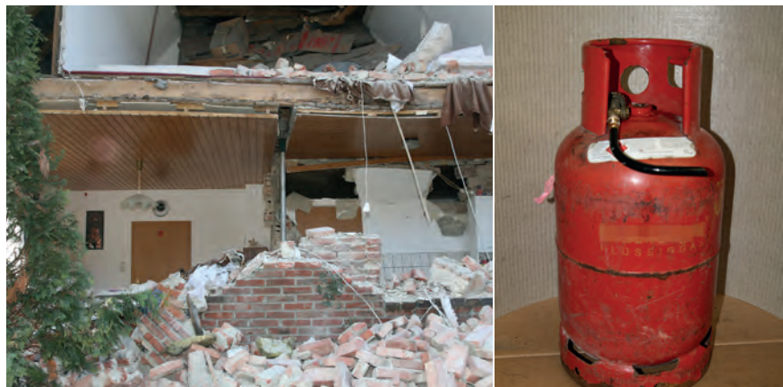
Ein Einfamilienhaus nach einem Explosionsschaden. Der Bewohner hatte einen Gasheizstrahler an die abgebildete Treibgasflasche angeschlossen.
