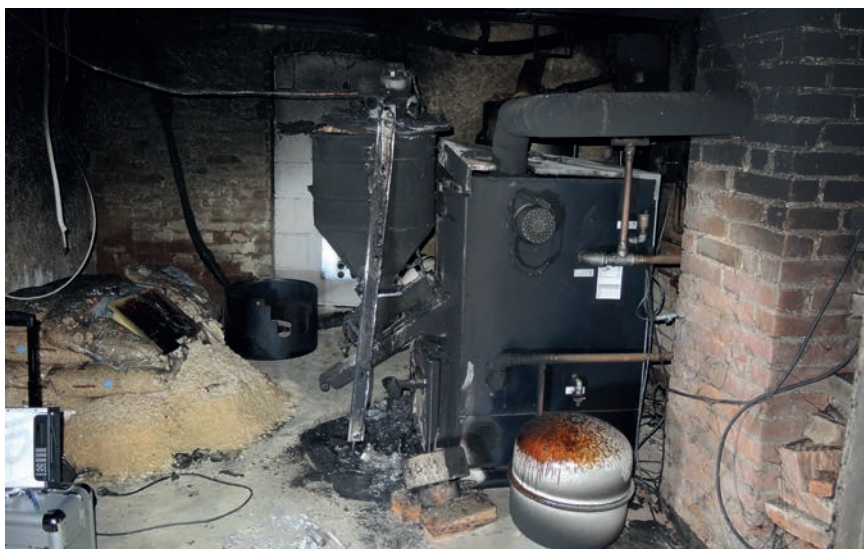
Ein Blick in den Heizungskeller: Hier beschränken sich die direkten Brandschäden auf den Pelletkessel des Herstellers Fröling. Foto: IFS
