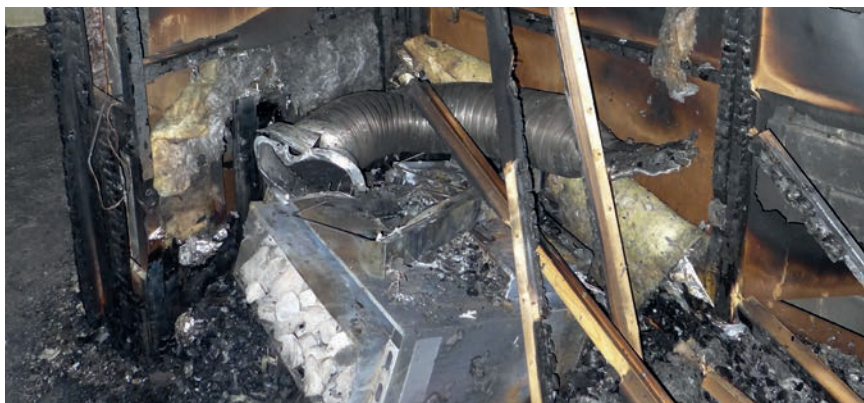
Brandschaden in einer Sauna. Das IFS hat bereits viele solcher Fälle untersucht. Die Erfahrungen daraus flossen in die DIN EN 60335-2-53 ein.
