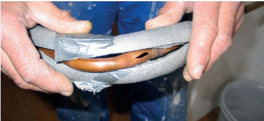
Das geplatze Kupferrohr befand sich in einer unbeheizten Abseite.
