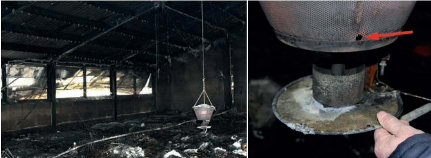
Im Stall hängen Gasstrahler. Rechts ist eine Fehlstelle im Lochblech zu sehen. Fotos: IFS
