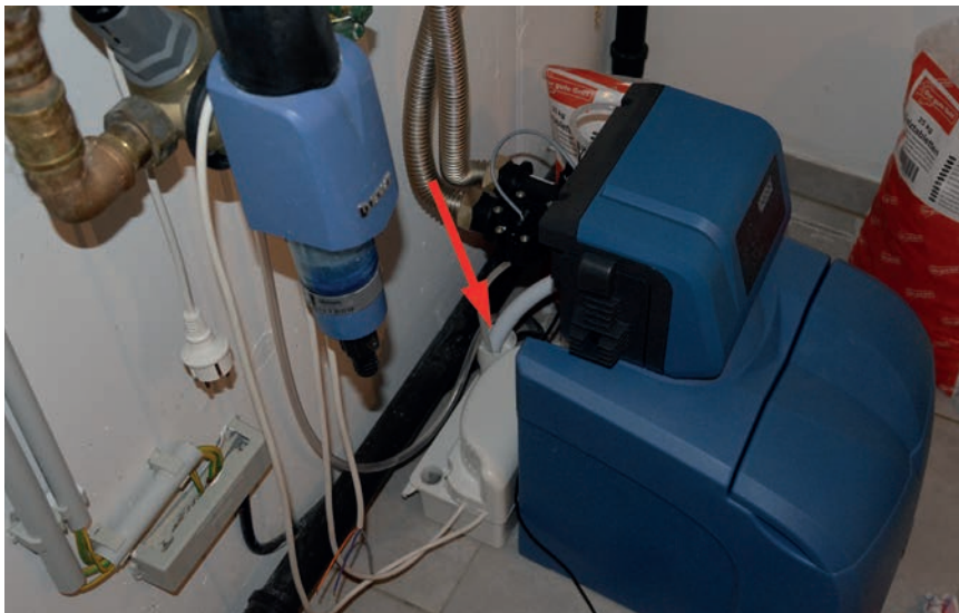
Die Anlage aus einem der beschriebenen Schadenfälle: Der Abfluss der blauen Enthärteranlage ist über eine Art Trichter in die ungeeignete weiße Pumpe geleitet (Pfeil).
