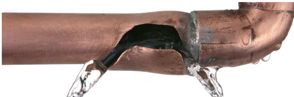
Ein durch Frosteinwirkung aufgeplatztes Kupferrohr
