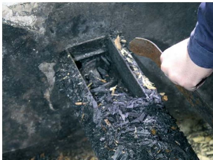
Brandspuren in der Förderschnecke einer Hackschnitzelheizung Foto: IFS
