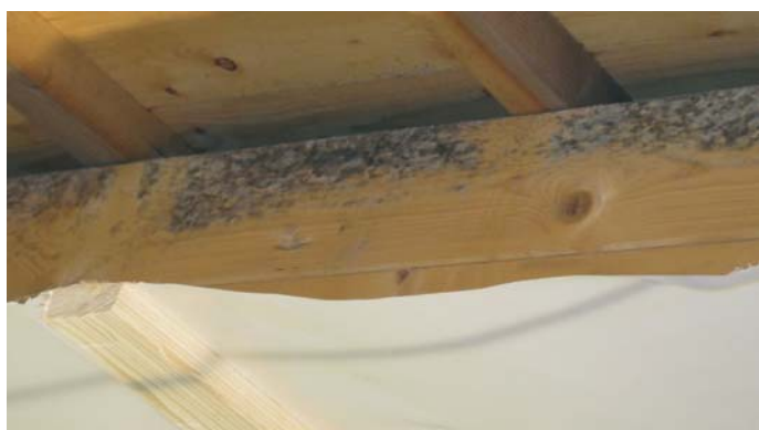
Schimmelpilzbefall an einem Dachbalken oberhalb der Dampfsperre
