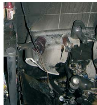
Schadenbild im Badezimmer
