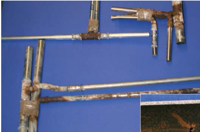
Die Rohrleitungen einer Heizungsinstallation wurden massiv durch Außenkorrosion geschädigt. Die Innenwände (Bild rechts) sind nicht angegriffen, doch der Wanddurchbruch von außen ist hier gut erkennbar.
