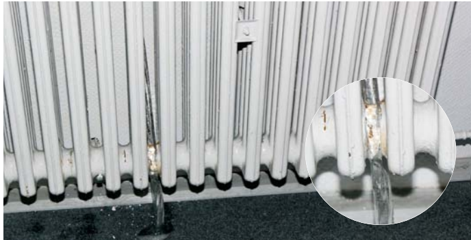
Gefrorene Leckage an einem Heizkörper
