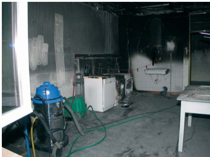
Blick vom Schulhof in den Brandraum in einer Schule
