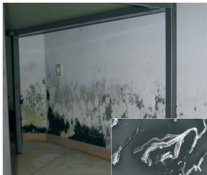
Schimmelpilzbefall an Wänden; ein Schimmelpilz unter dem REM
