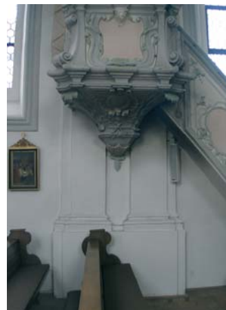
Brandfolgen in einer Kirche: Die Unterseite der Kanzel ist stark verunreinigt.
