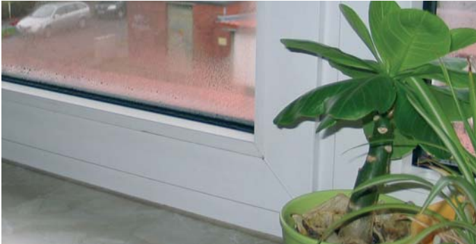
Ein deutliches Warnsignal: Wasser kondensiert an der Fensterscheibe.
