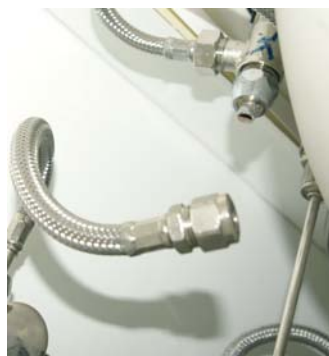
Der Warmwasseranschluss hat sich direkt unterhalb der Waschtischarmatur gelöst.
