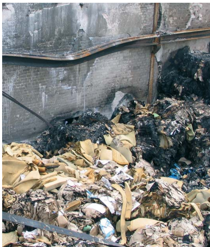
Die Verformung an der Schiene belegt eine starke Hitzeeinwirkung.
