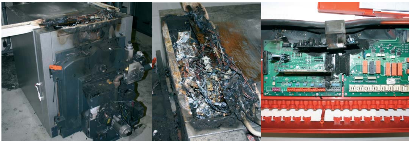
Der Heizkessel bei der Ortbesichtigung (links): Es ist ein deutlicher Schadensschwerpunkt an der integrierten Kesselsteuerung zu erkennen, die auf den Kessel montiert ist (mittleres Bild). Rechts: Auf dieser Grundleiterplatte ist das Feuer entstanden.
