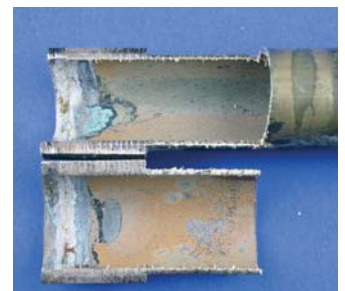
Im Inneren des Messingrohres zeigen sich deutliche Anlaufspuren.
