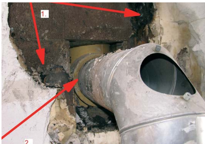
Das einwandige Abgasrohr verläuft durch eine Leichtbauwand hinter dem Kamin. Im Bereich des Durchbruchs sind die Holzbalken stark brandgezehrt.
