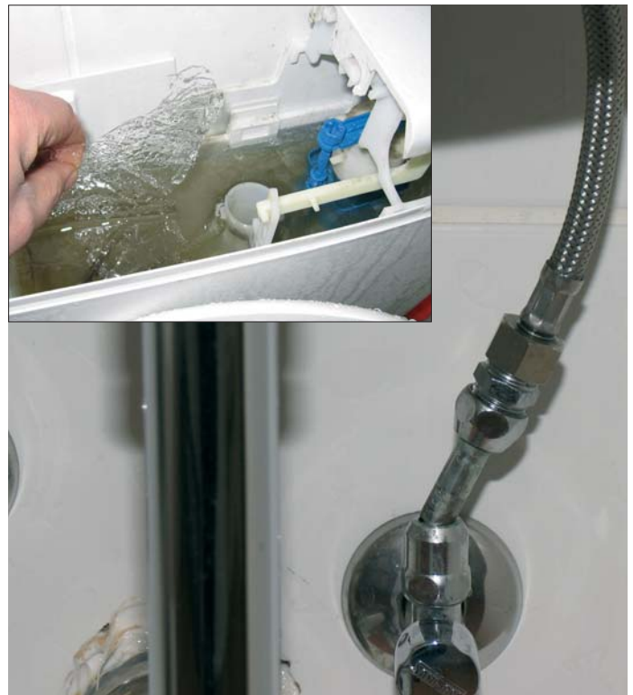
Der verlängerte Anschluss-Schlauch der Waschtisch-Armatur wurde aus der Klemmverschraubung gedrückt. Kleines Bild: Eis im Spülkasten
