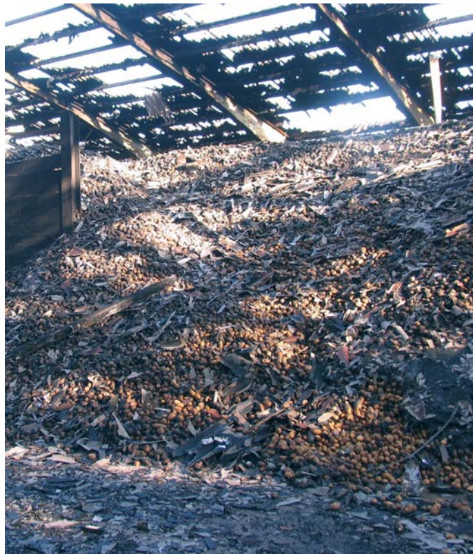
Die ausgebrannte Lagerhalle
