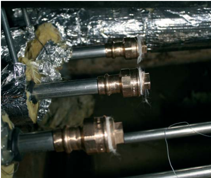
Bei dieser Aufnahme wurde der Fehler bereits korrigiert; die abgetrennten Rohrleitungen wurden mit Pressfittings und Stopfen verschlossen.
