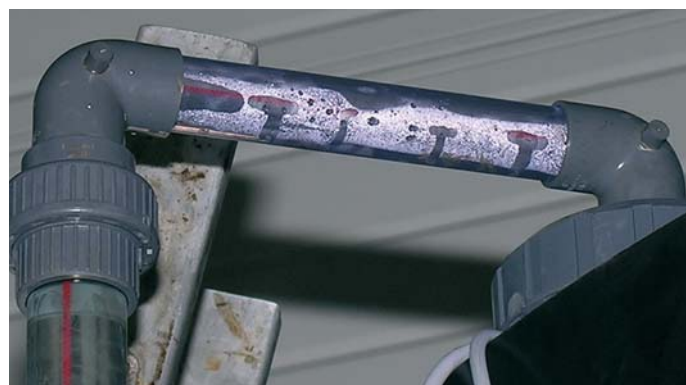
Die Leckagestelle an der Füllstandsanzeige vom Klebeband befreit: Der Flüssigkeitspegel steht wegen der Überfüllung an der Unterseite des Querrohres.
