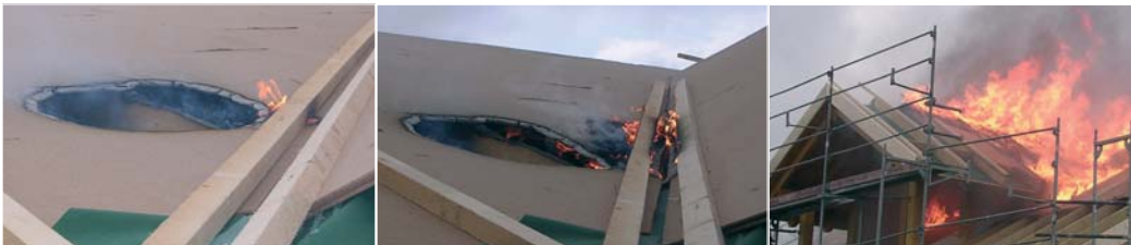
Die Bilder zeigen die Brandentwicklung am Dachstuhl eines Rohbaus, die der Bauherr zufällig dokumentieren konnte.
