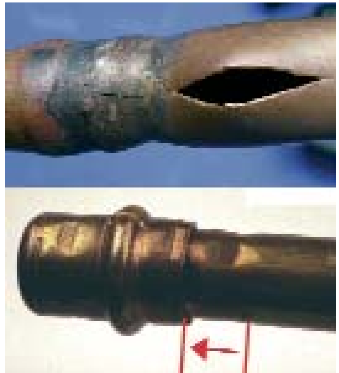
Zwei typische Frostschäden: Im oberen Bild ist das Rohr aufgeplatzt, im unteren wurde die Verbindung auseinandergedrückt (siehe Pfeil). Fotos: IFS
