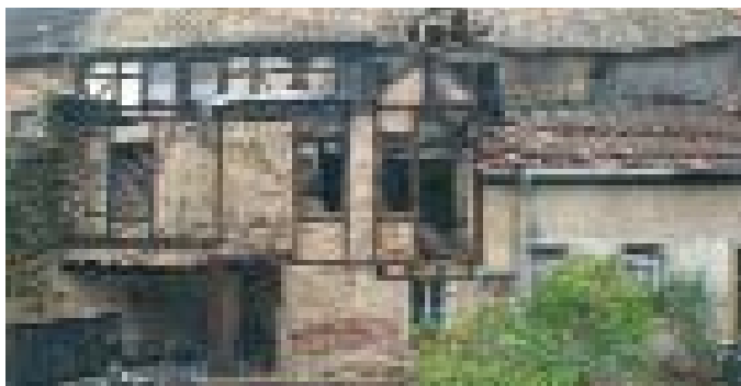
Der Anbau der Mühle: Das erste Stockwerk ragt über das Erdgeschoss hinaus
