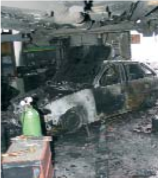
Der Blick von der Hebebühne zu dem ausgebrannten Fahrzeug: In der Bildmitte ist die Ablaufrinne zu sehen; links im Bild steht das Schweißgerät.
