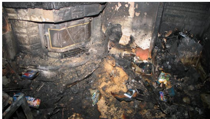
Der Brandschwerpunkt: Zu nah am Ofen gelagertes Brennmaterial und der fehlender Schutz des Laminatbodens wirkten brandfördernd.
