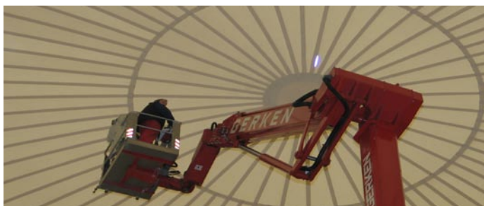
Deutlich sichtbar ist die Schadstelle nahe des Kuppelzentrums. Ein Hubsteiger dient dem Gutachter als Arbeitsplattform und verdeutlicht hier die Dimensionen.
