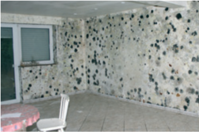
Schimmelschaden nach einer Durchfeuchtung in einem leer stehenden Gebäude
