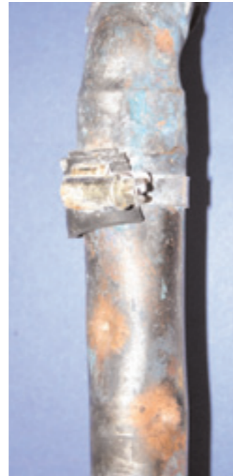
Ein Wanddurchbruch wurde mit zwei Gummistücken und einer Schlauchschelle geflickt; weitere Eindellungen der Rohrwand sind deutlich zu erkennen.
