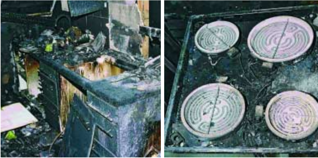
An der freien Stelle in der Küchenzeile hatte vor dem Feuer ein Elektroherd gestanden, der von der Polizei asserviert wurde. Rechts: Das Ceranfeld wurde vollständig zerstört; das Bild zeigt den Blick auf die darunter liegenden Heizeinheiten.
