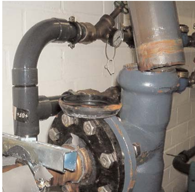
Hier wurden Doppelmuffen mit Flanschstutzen, MMA-KS, verwendet. Die Verbindung im Hausanschlussraum ist am T-Stück auseinandergebrochen.
