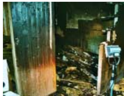
Der Kellerraum, in dem das Gerät aufgestellt war
