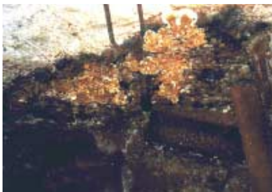
Der Echte Hausschwamm kann weit reichende Schäden verursachen.
