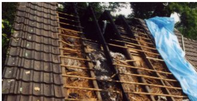
Der verbrannte Dachstuhl gab den Entstehungsort der Flammen schnell preis. Foto: IFS
