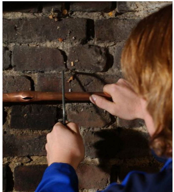
Vorsicht bei fallenden Temperaturen: Durch Frost berstende Wasser- und Heizungsrohre können erhebliche Sachschäden zur Folge haben. Foto: Verband öff. Versicherer
