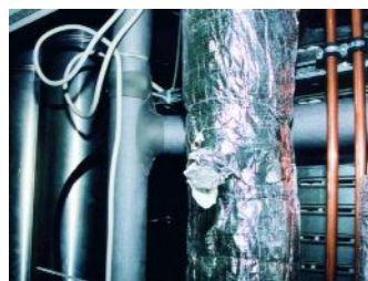
Kalt- und warmgehende Rohre berachbart
