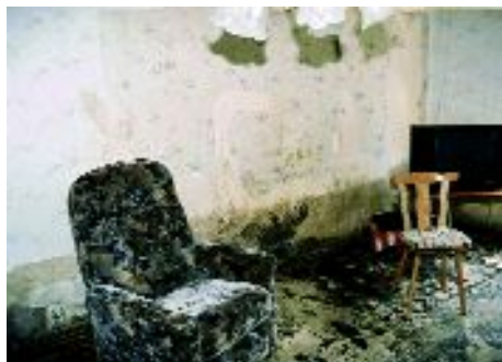
Schimmelpilzbefall nach einem Überflutungsschaden
