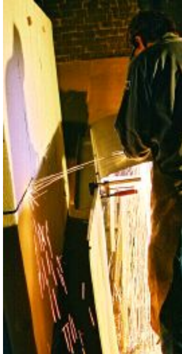
Schweißerarbeiten an Tanks: Haben Funken die Isolation in Brand gesetzt? Foto IFS
