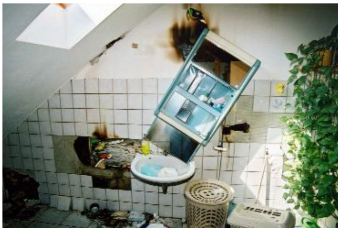
Durch den Brand wurden unter anderem zwei Badezimmer in Mitleidenschaft gezogen
