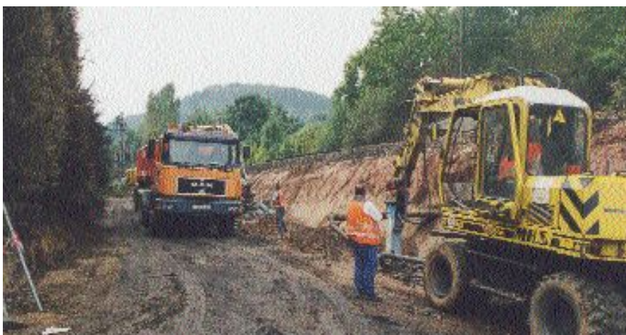
Nach den Löscharbeiten wird Erdreich am Bahndamm ausgebeigert
