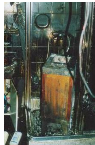
Angrenzende Bereiche wurden durch Rußablagerungen stark beschädigt
