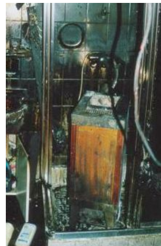
Angrenzende Bereiche wurden durch Rußablagerungen stark beschädigt
