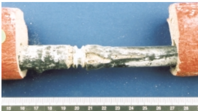
Mehrschichtmetallverbundrohr ursprünglich in Dämmschicht unter Estrich verlegt, vollständige Auflösung des Metallmantels aus Aluminium durch Korrosion.
