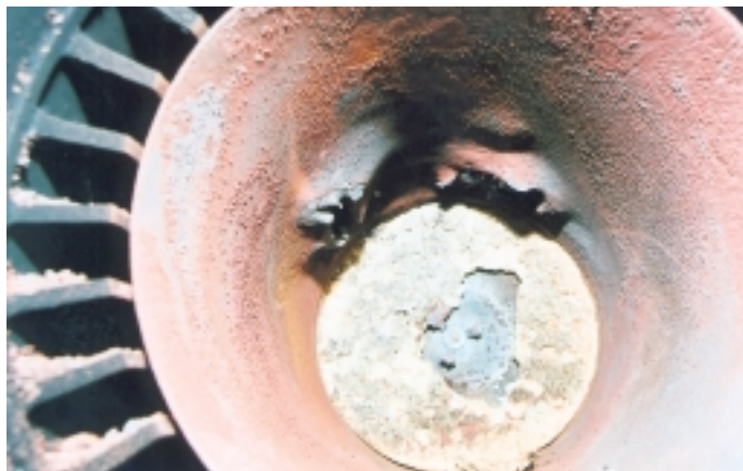
Deutlich zu sehen: Die starke Deformation am Brennertopf
