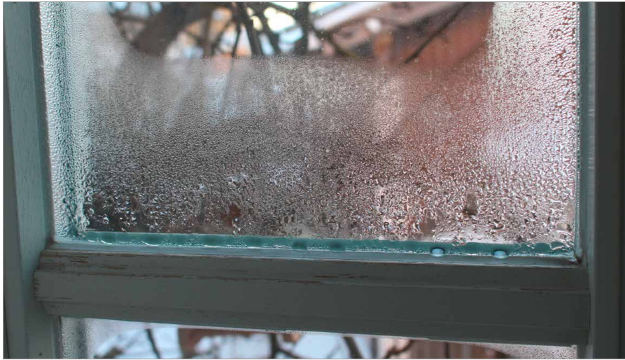
Am kalten Fenster kondensiert die Feuchtigkeit aus der Raumluft.
