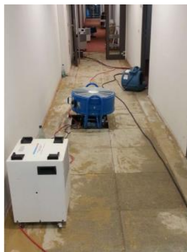
Nach einem größeren Wasserschaden ziehen sich die Trocknungsarbeiten oft über Wochen hin. Das führt zu einem Nutzungsausfall.
