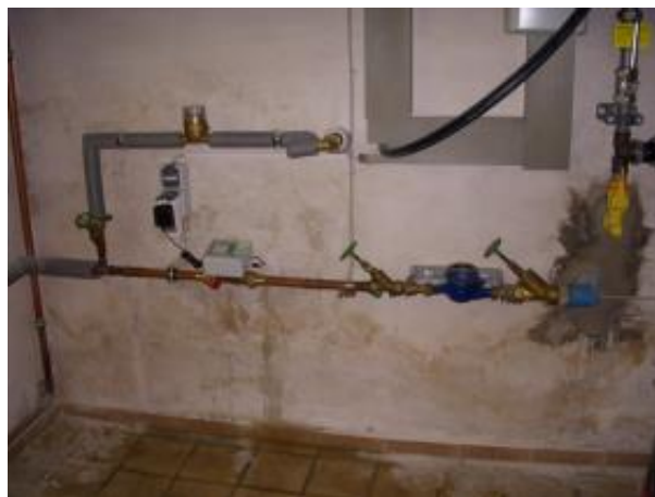
Installation eines Leckagedetektors in einem Einfamilienhaus. Der Installationsaufwand ist gering. Im Schadenfall können typischerweise maximal 150 l Wasser austreten.
