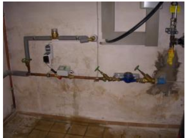
Installation eines Leckageschutzsystems in einem Einfamilienhaus. Der Installationsaufwand ist gering. Im Schadenfall können typischerweise maximal 150 l Wasser austreten.
